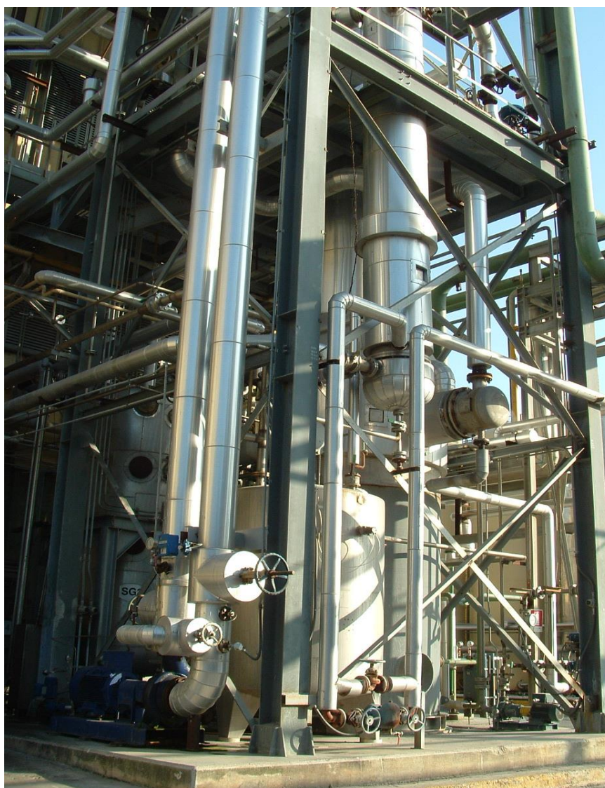
L'impianto di produzione biodiesel di Fox Petroli, recentemente sottoposto a revamping.
