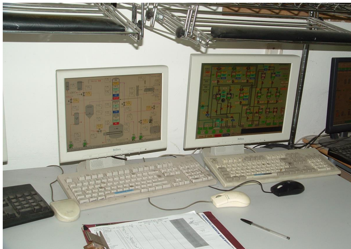
Particolare della Sala Controllo dell'impianto di Biodiesel. Tramite le stazioni di supervisione Movicon ridondate, gli operatori controllano l'intero processo.
