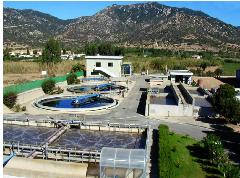
Il sistema di monitoraggio e telecontrollo del depuratore è stato realizzato da Anova Srl di Napoli.
